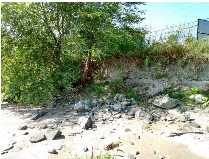
Photographie 1. Signes d'érosion éventuellement causés par « l'effet de bout ».
