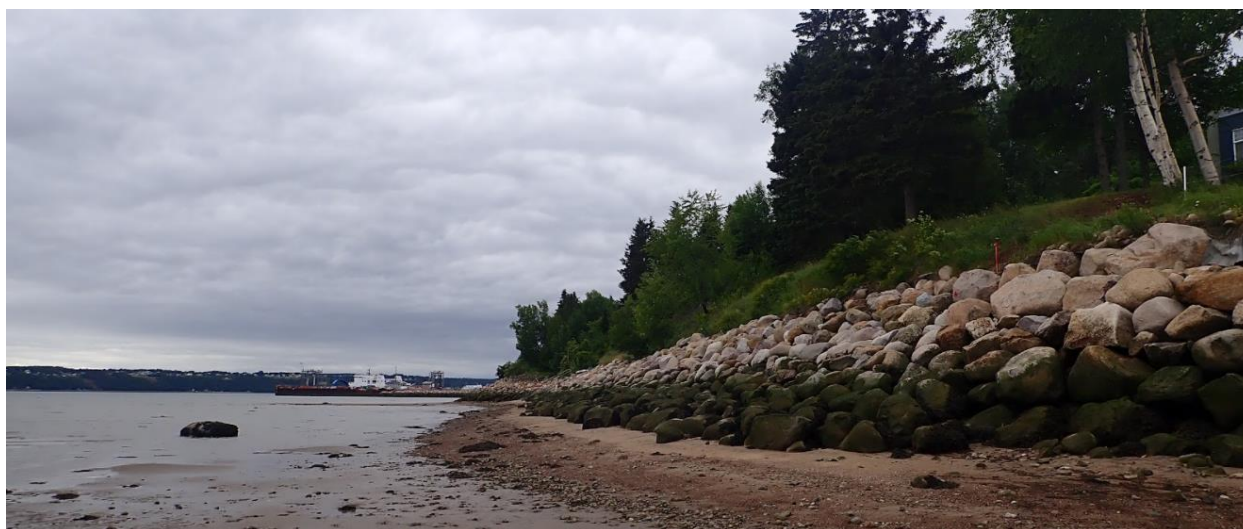
Figure 7. Falaises enrochées situées entre le quai de Saint-Joseph-de-la-Rive et le Musée maritime de Charlevoix
