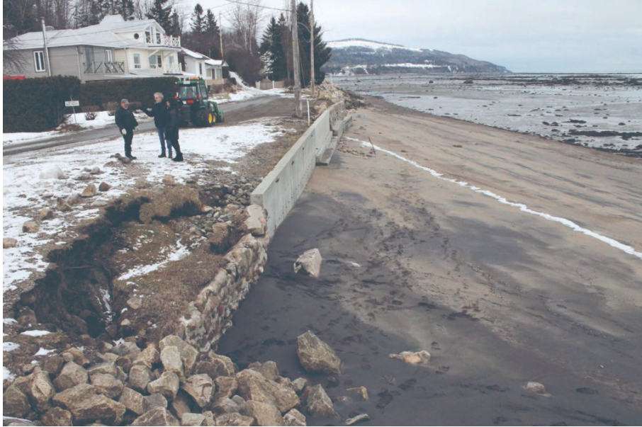
Figure 5 : Affaiblissement d'un muret, plage du Traversier (Le Charlevoisien, 2018)
